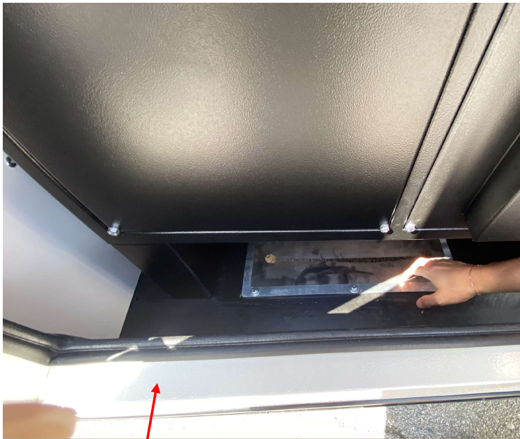
Área dedicada para la entrada de cables ubicada debajo del panel de control
